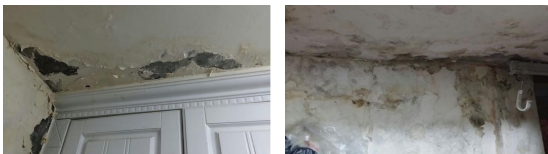
圖五：受訪者牆身出現裂痕，但業主甚少處理
