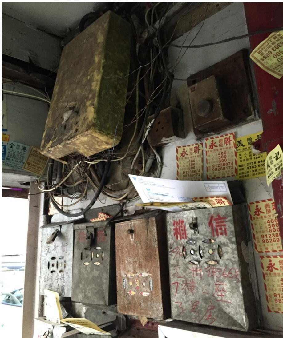
大廈公共空間的電線外露問題嚴重
