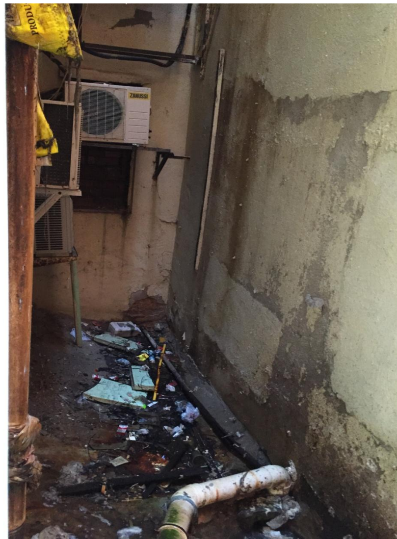
單位對出的天井衛生問題嚴重，長期有垃圾及積水
